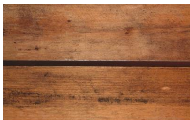
Prima del trattamento
